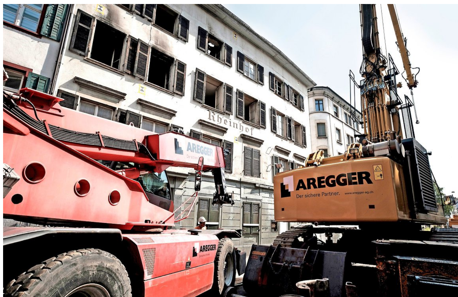
Den Greifbagger in die enge Rheingasse zu manövrieren, sei nicht einfach gewesen, so die Gebäudeversicherung Basel-Stadt. Foto: Dominik Plüss
